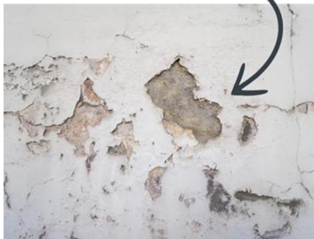
MUR ØDELAGT AF FUGT
